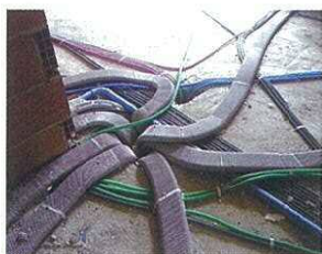
◀熱交換型換気用の配管など。これら配線・配管類は軽量コンクリートの下にコロシとなる。
